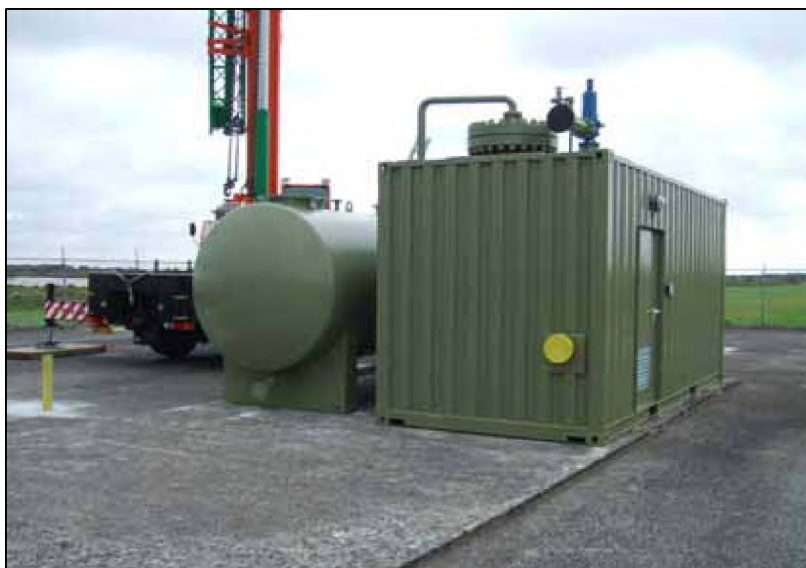
Figuur 5: Voorbeeld van een skid met daarnaast een bovengrondse opslagtank
