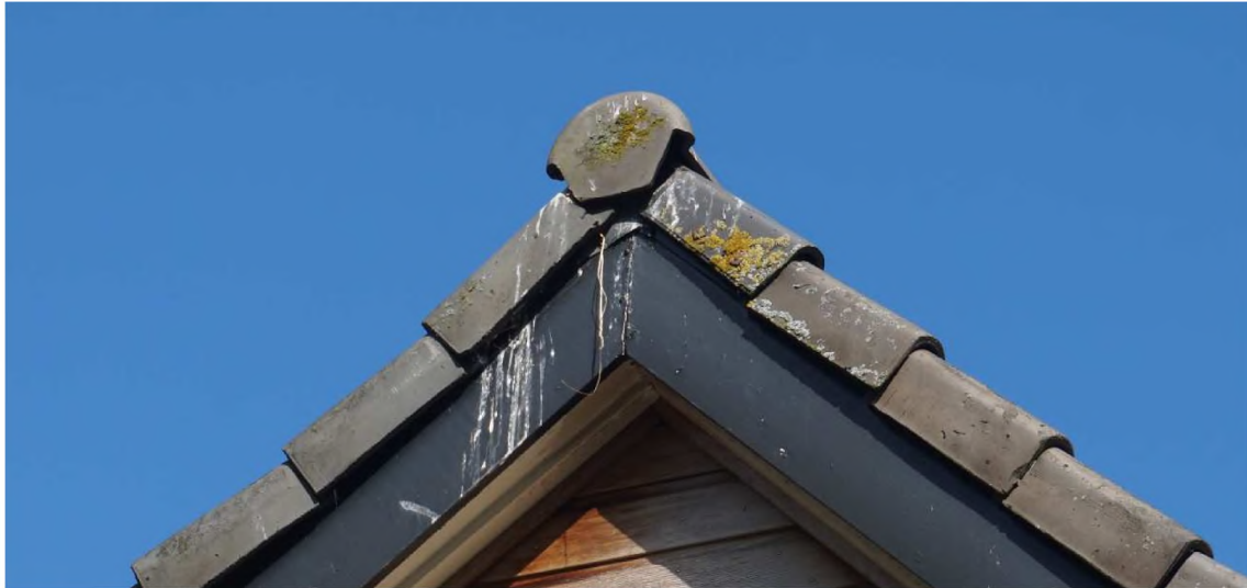
Figuur 5.1. Mestsporen aan dakconstructie.
