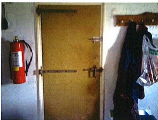
Foto 1. Asbesthoudende deurbeplating op deur
