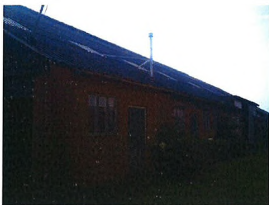
Foto 7. Asbesthoudende golfplaten logboxenstal
