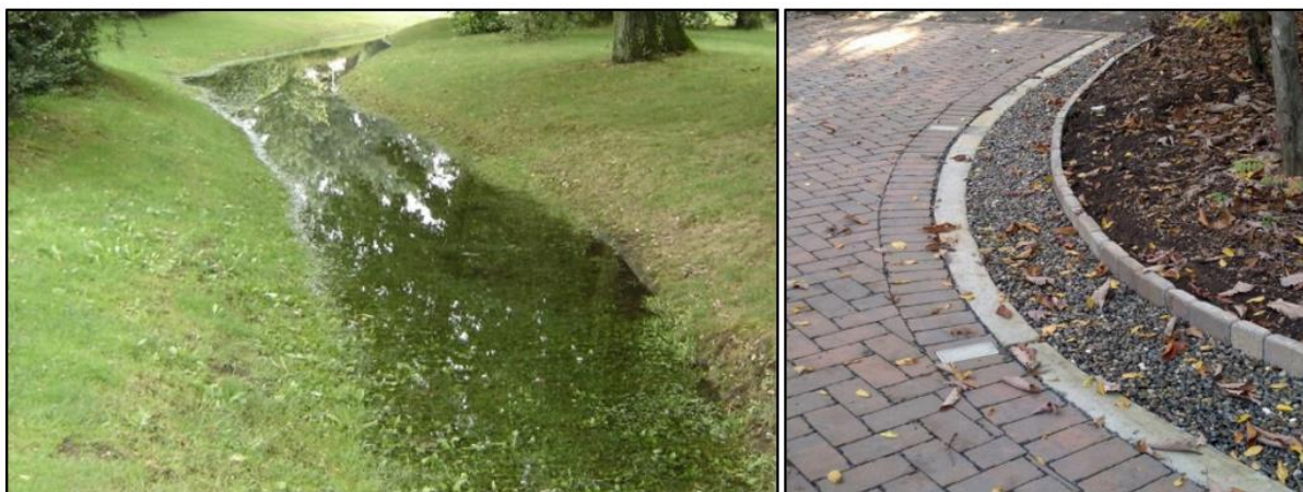
Figuur 13: infiltratievoorzieningen op maaiveldniveau
