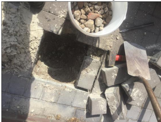
Foto 10: : Asbestgat B13 (d.d. 13 augustus 2020)
