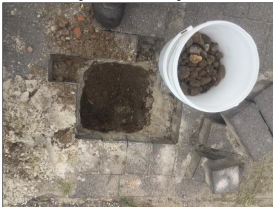
Foto 8: Asbestgat B04 (d.d. 12 augustus 2020)
