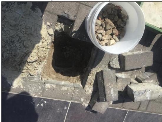
Foto 9: : Asbestgat B12 (d.d. 13 augustus 2020)
