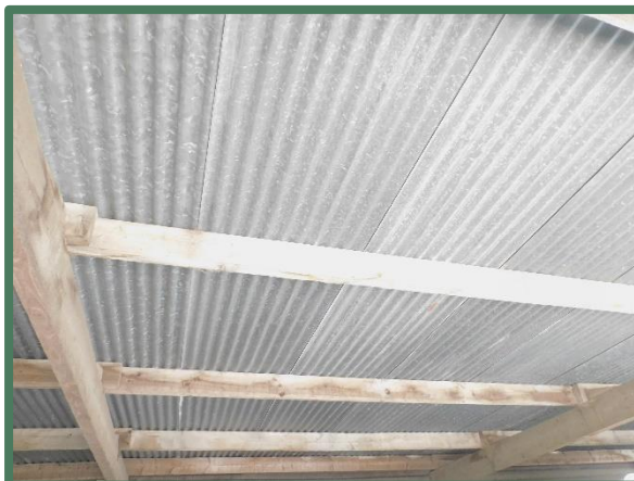
Niet geïsoleerd of onderschoten dak aanbouw
