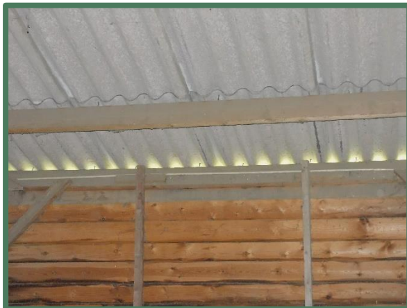
Goed te controleren open dakrand achterste schuur
