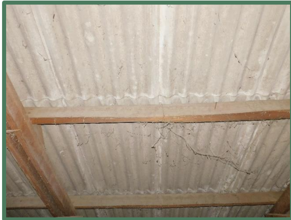
Niet geïsoleerd of onderschoten dak voorste schuur
