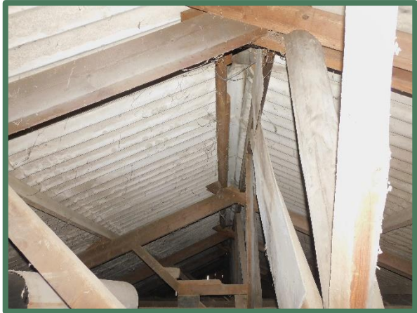
Niet geïsoleerd of onderschoten dak voorste schuur op zolder
