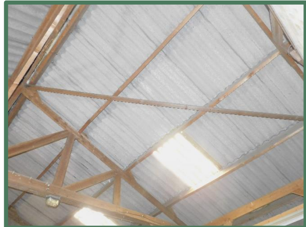
Niet geïsoleerd of onderschoten dak achterste schuur
