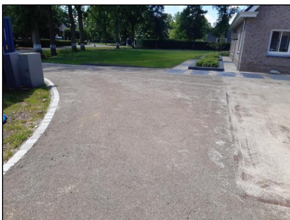
Inrit gemaakt van waterdoorlatende verharding. Betreft een waterdoorlatend product met een landelijke uitstraling bijv. Revicon
