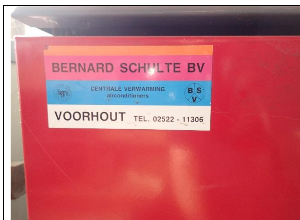
Foto 13. Airco, niet verdacht, voormalig tuincentrum
