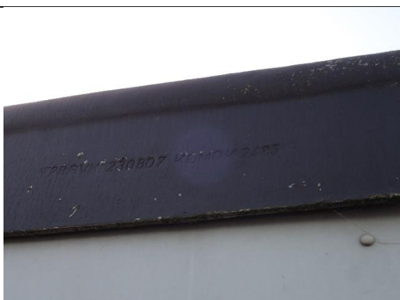
Foto 9. Aanbouw loods, asbestvrije golfplaten (NT met KOMO nummer)
