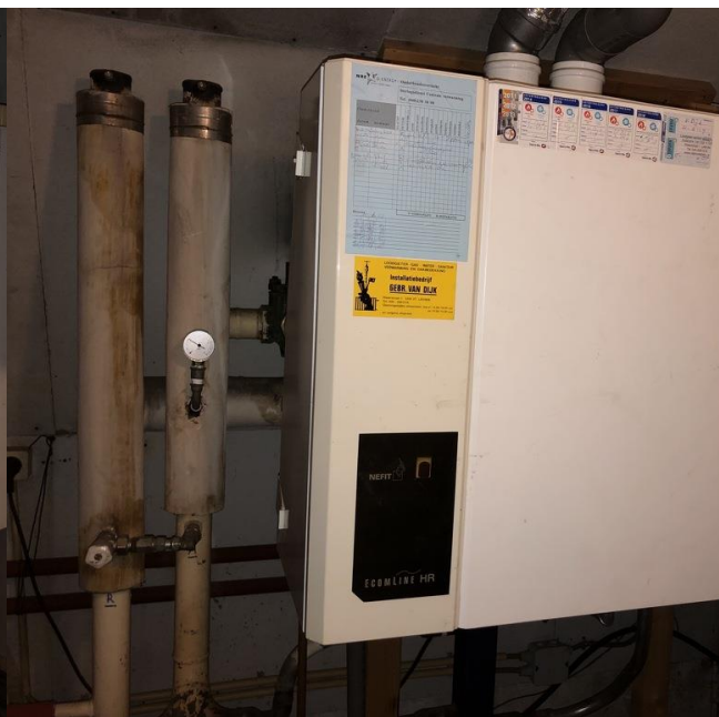
C.v. installatie verdieping
