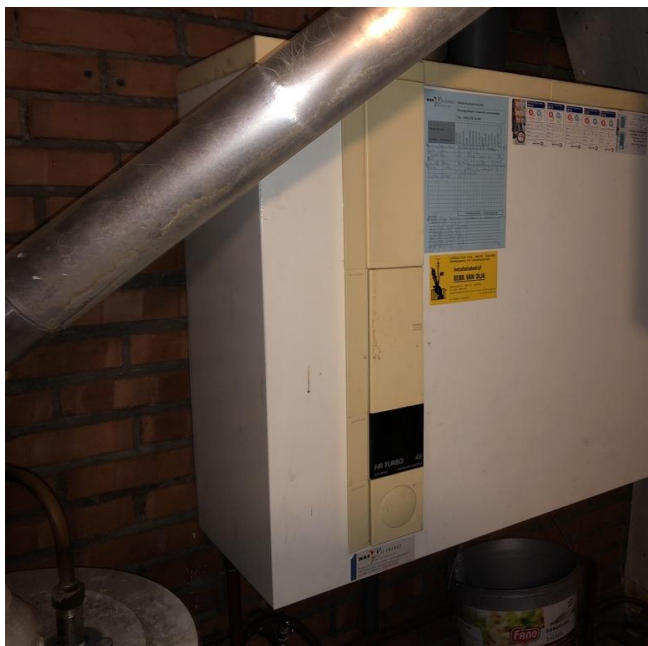
C.v. installatie verdieping
