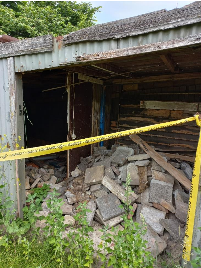
Vervallen schuur ten westen van de schakeltuin
