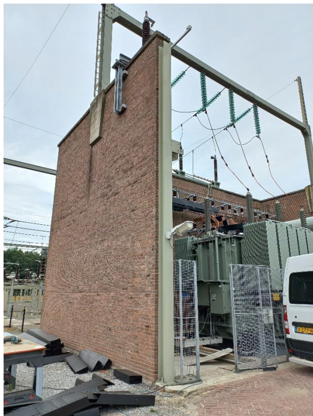
Eén van de transformatoren waar tegenaan gebouwd wordt.
