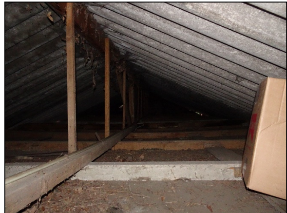
Figuur 12. De donkere zolder van een van de schuren op de onderzoekslocatie.
