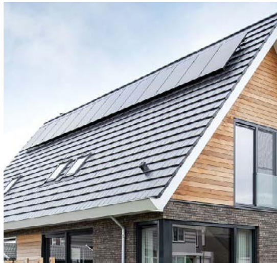
Zonnepanelen in hoogterichting, 0,3 meter onder de nok.
