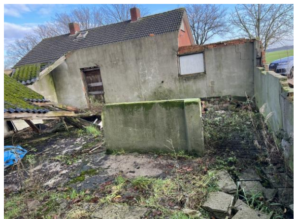
Overzicht schade stal 2
