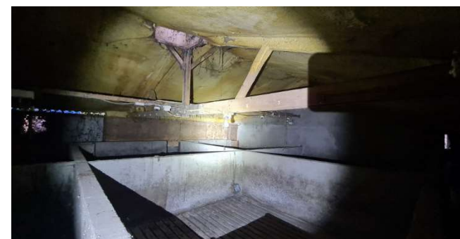
Figuur 6: Gedeeltelijk ingestorte bedrijfshal in het oosten van het plangebied
