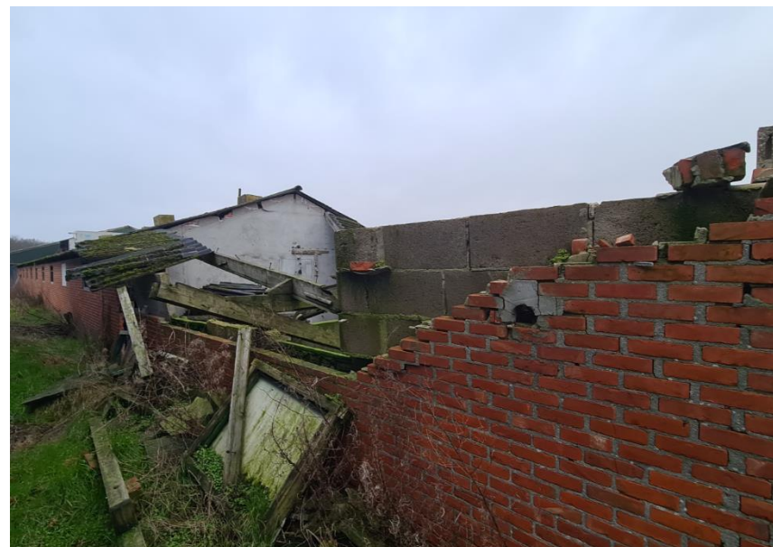
Figuur 7: Gedeeltelijk ingestorte bedrijfshal in het oosten van het plangebied
