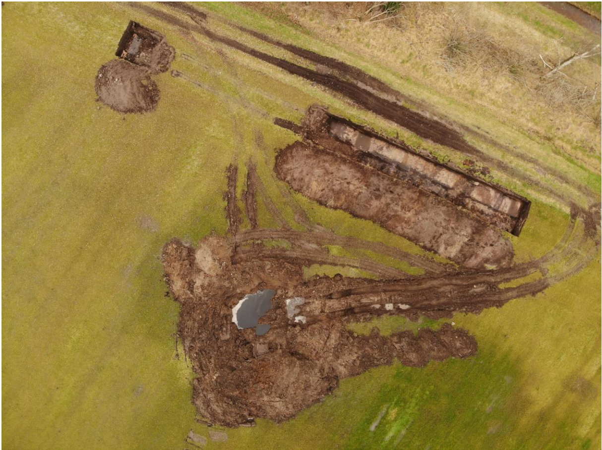
Figuur 9: De volgestroomde put en de daar omheen gelegen baggerzone die is ontstaan door het vastrijden en weer bevrijden van de hier vastgereden graafmachine.
