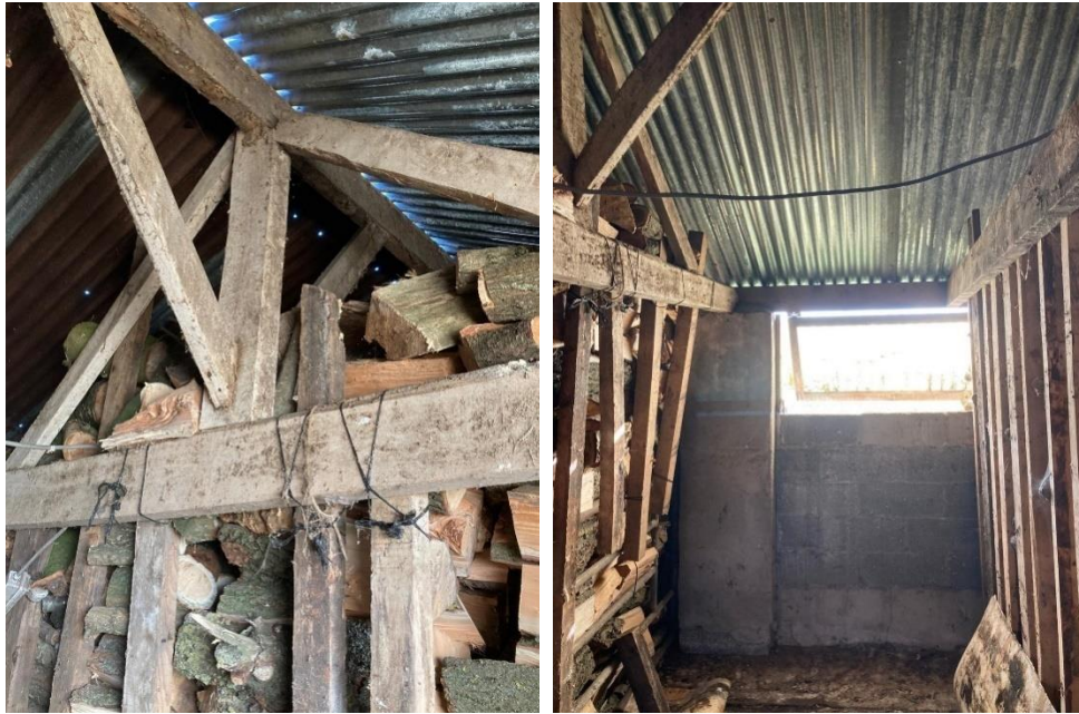
Afbeelding 11 Binnenzijde stal met golfbeplating (geen isolatie), geen spouwmuur en open nok (tochtig)
