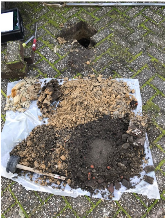
Boring 13, asbestverdachte golfplaat
