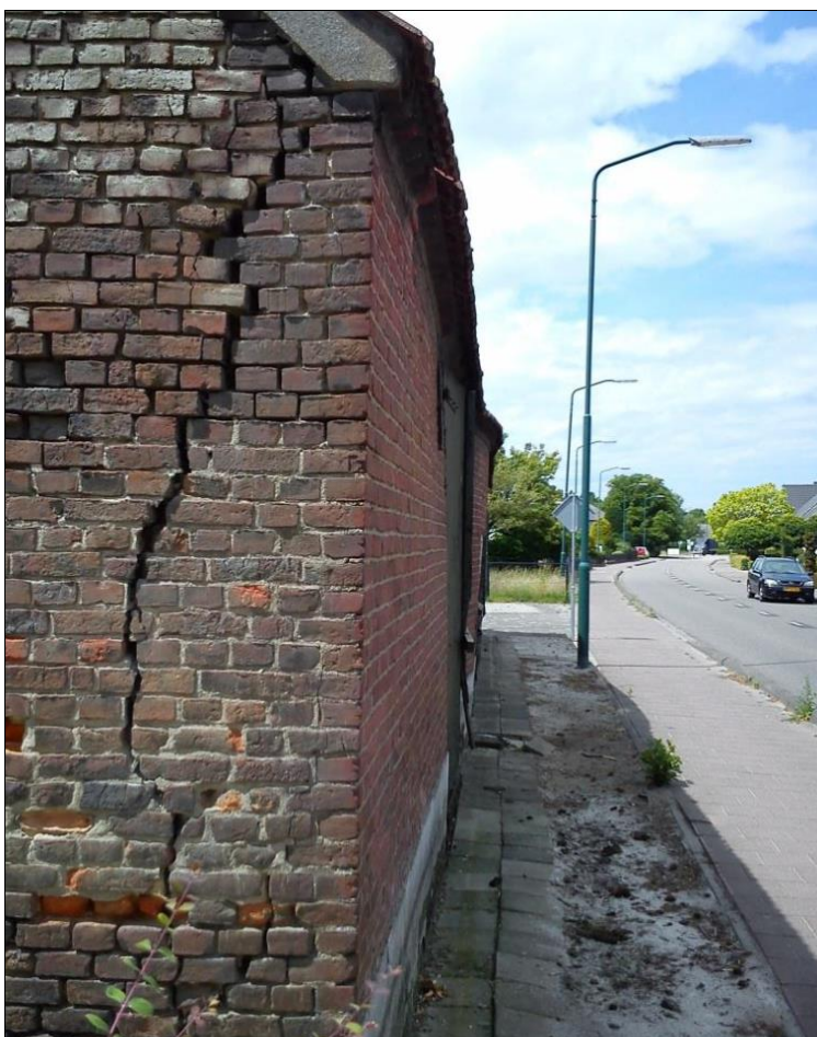
Figuur 5: Verzakkende voorgevel en ligging tegen de openbare weg 2019
