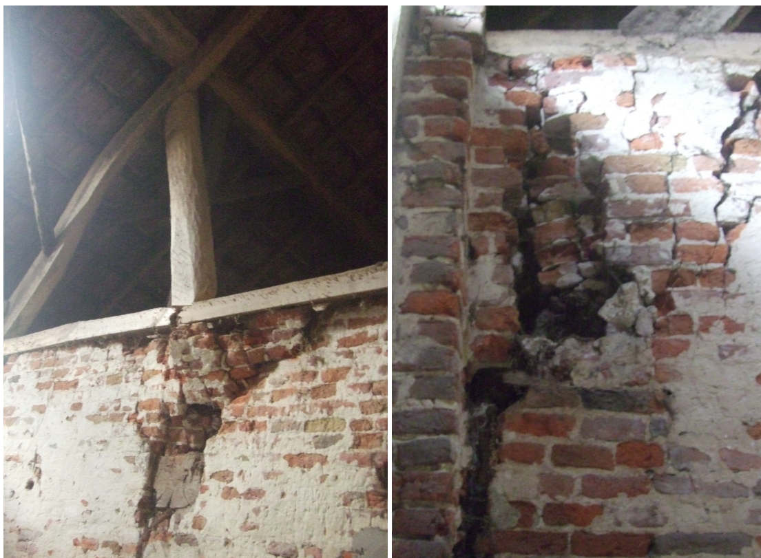
Draagconstructie in zeer slechte staat
