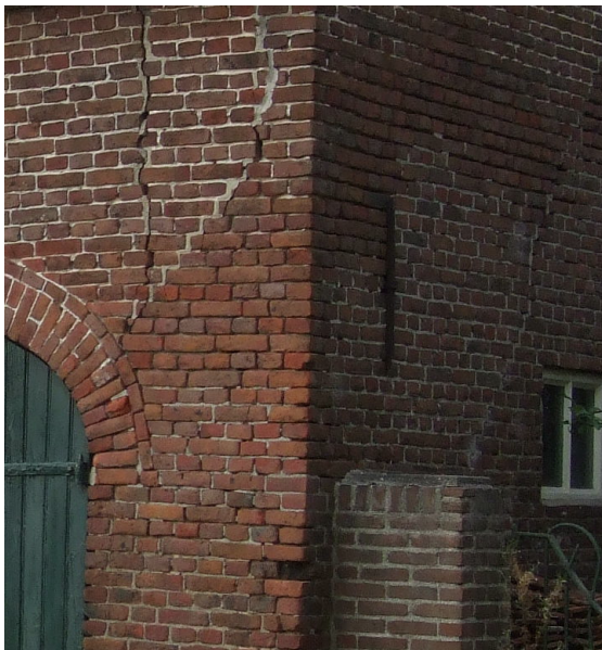
Scheuren in metselwerk
