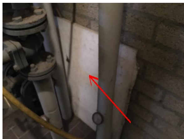
Brandwerende beplating los
