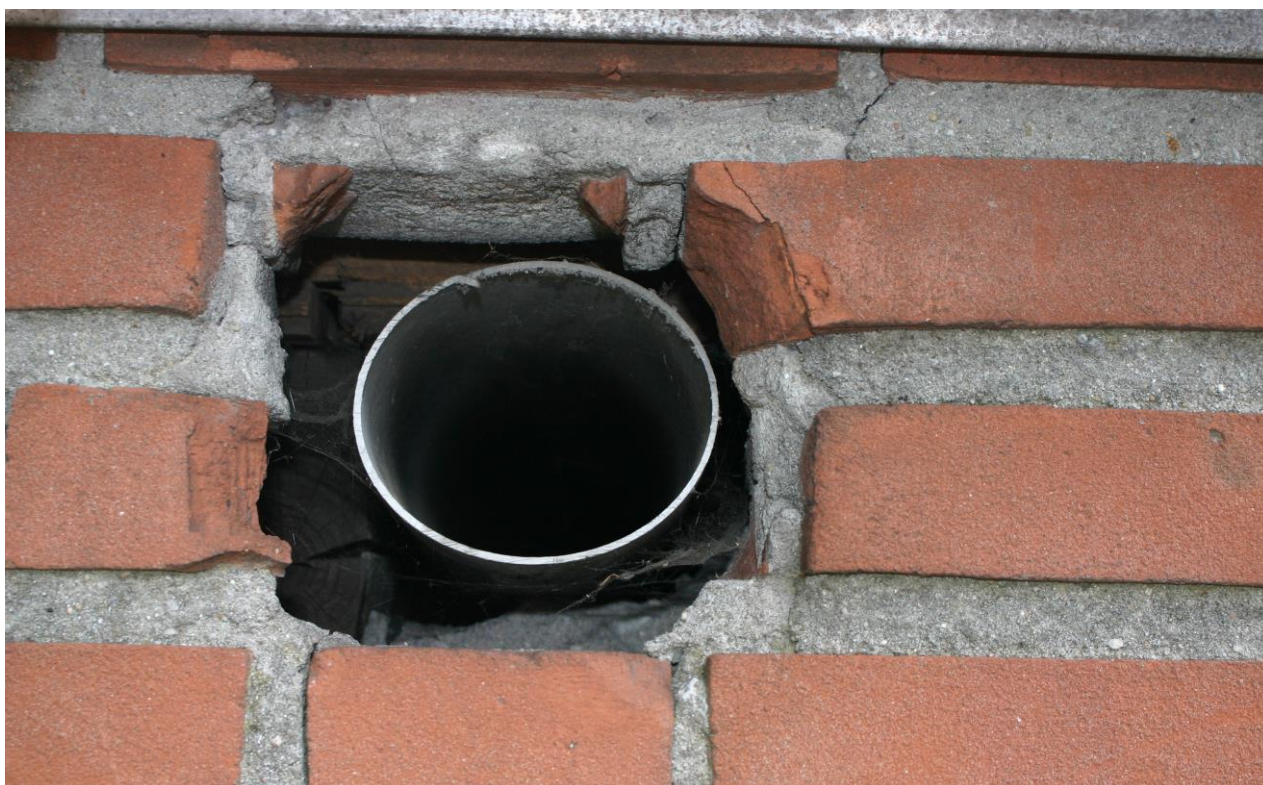
Figuur 4.5.3. Een van de gaten in de muur van de autogarage.
