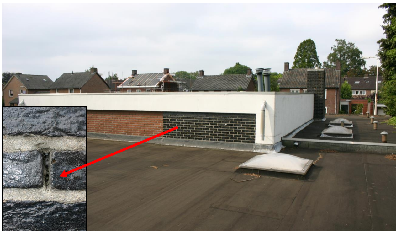
Figuur 4.5.2. In het plangebied zijn enkele open stootvoegen waargenomen, waarin zich spinnenwebben (zie detailfoto) bevinden.
