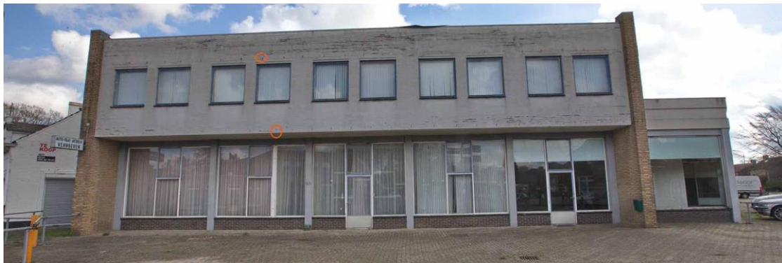
Figuur 8: Zicht op het kantoorgedeelte van het garagepand. Rode arcering: open stootvoegen die over de gehele voorgevel aanwezig zijn.
