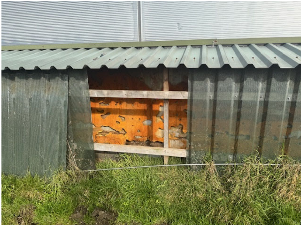
• Afbeelding 17: achtergevel met veel beschadigingen als gevolg van corrosie
