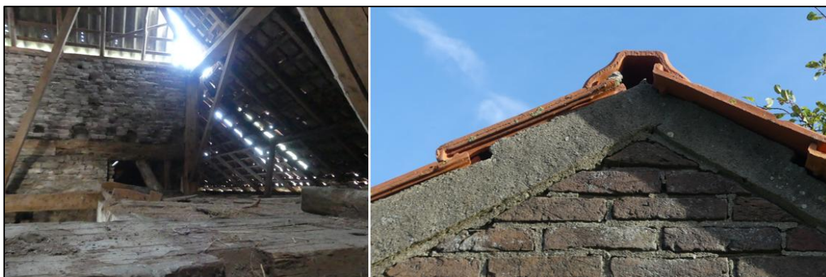
Figuur 3.3 Links: gebouw 1 is toegankelijk via kierende dakpannen en bevat donkere hoeken om in weg te kruipen. Rechts: gebouw 3 heeft een toegankelijk dakbeschot via afgebrokkelde specie.
