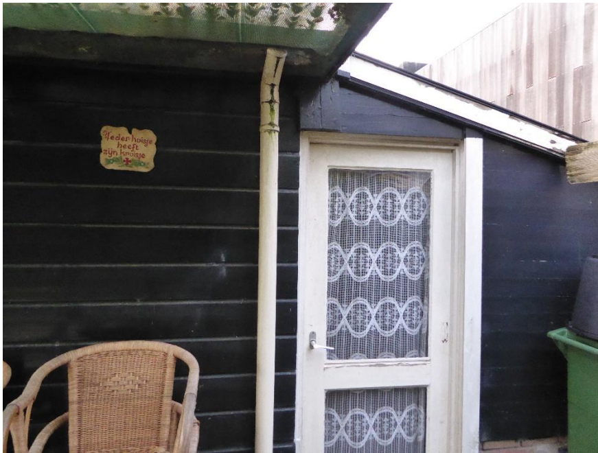
Impressie van het pand, het betreft een bouwlaag met golfplaten overkapping en is in (zeer) vervallen staat.
