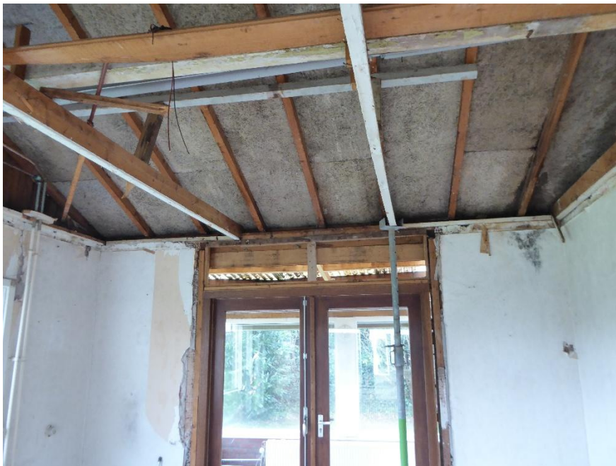
Impressie van de inpandige staat. Er is geen dakbeschot aanwezig.
