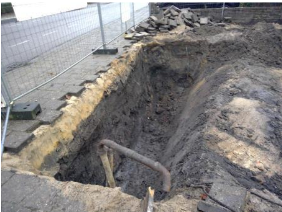
Foto 1: Locatie van de gesaneerde benzinetank zuidelijk van het voormalige pand.
