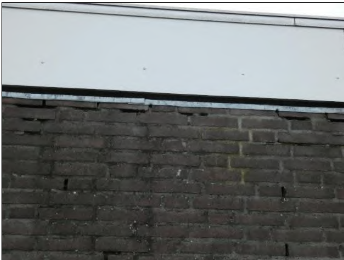
Figuur 9: Open stootvoegen en ruimten in muur en dakrand van het hoofdgebouw.
