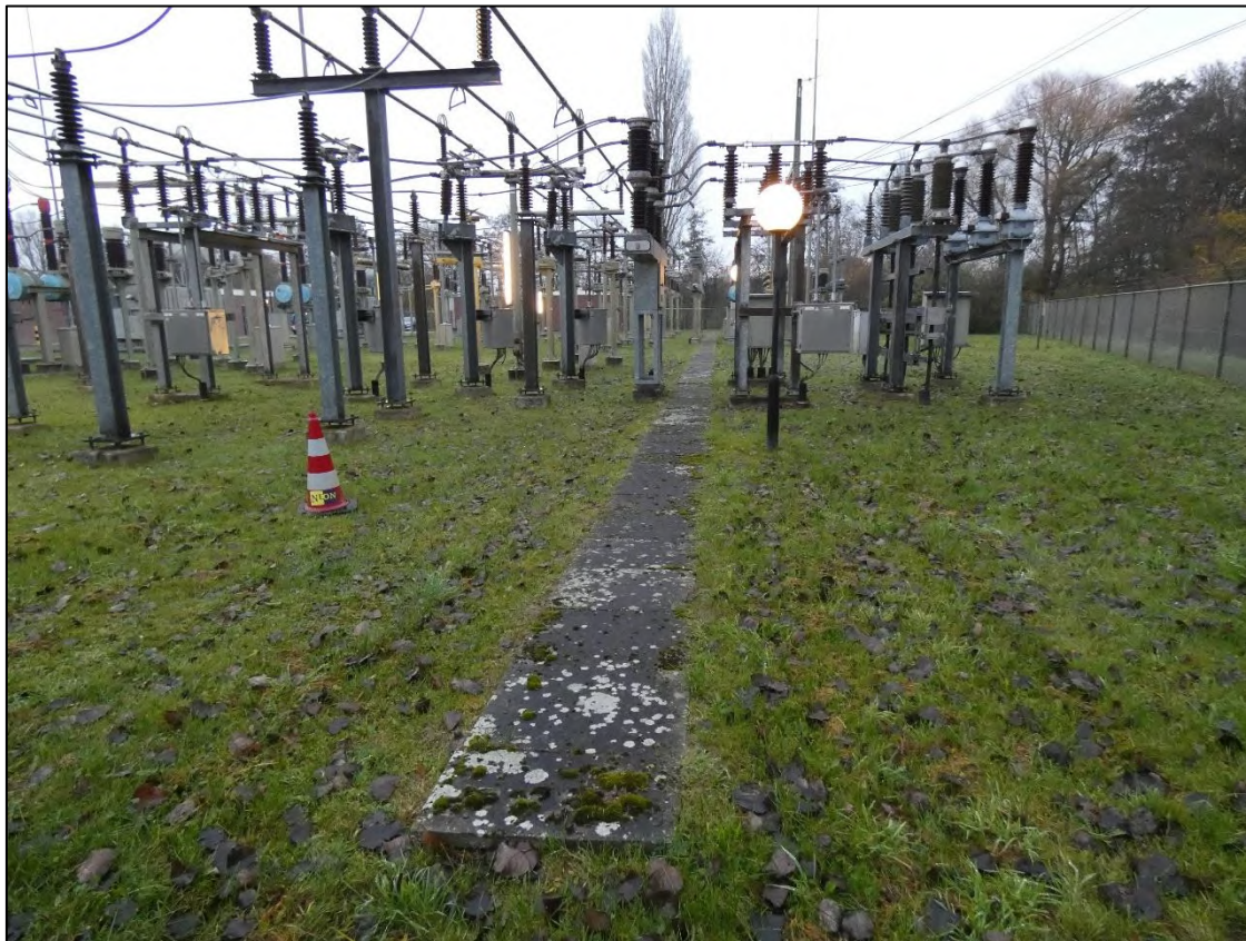
Figuur 13: Verharde paden in de schakeltuin.
