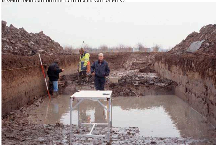
Figuur 3. Hoge grondwaterstand in werkput 2.
