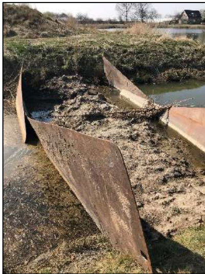
Foto 3. Noordelijk doorgebroken dam
