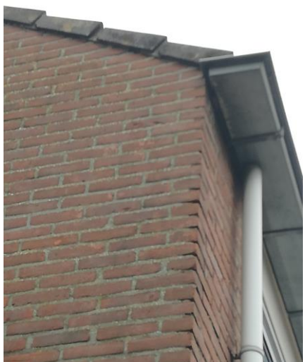
Figuur 4.5.2. De gevelpannen op de hogere woningen liggen los op de gevel.
