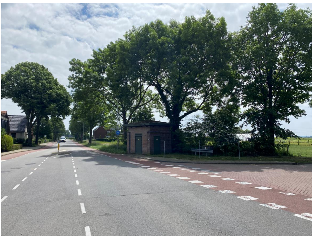
Transformatorhuisje in groenstructuur
