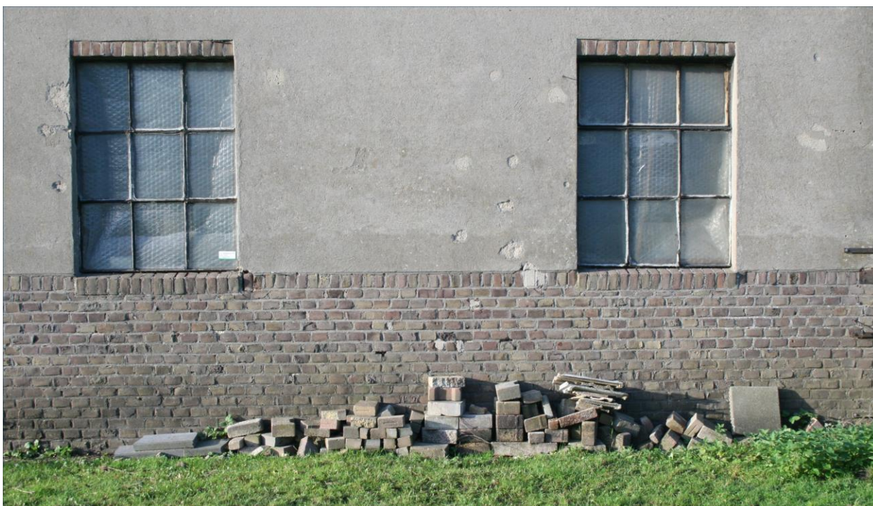
Afbeelding 2.3: Deel van de muur aan de noordoostzijde van het gebouw met daarin de vermoedelijke (granaatscherf-) inslagen te zien. Foto: Greenhouse Advies.
