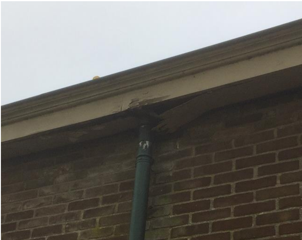
Figuur 5. Boeiboord met schade, potentieel geschikt voor vleermuizen.
