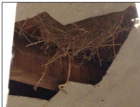
Foto 12. Gat in dak in aanbouw aan gebouw 2
