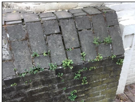
Foto 16. Muurvarens op muurtje aan gebouw 4
