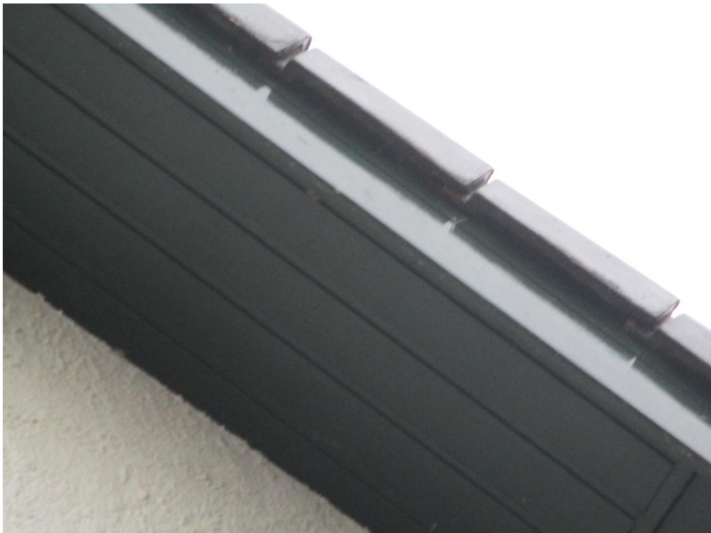
Figuur 4 Onder de kantpannen zijn beschilderde boeiboorden gelegen. Door het schilderwerk zijn deze glad en kunnen vleermuizen hier niet op landen.
