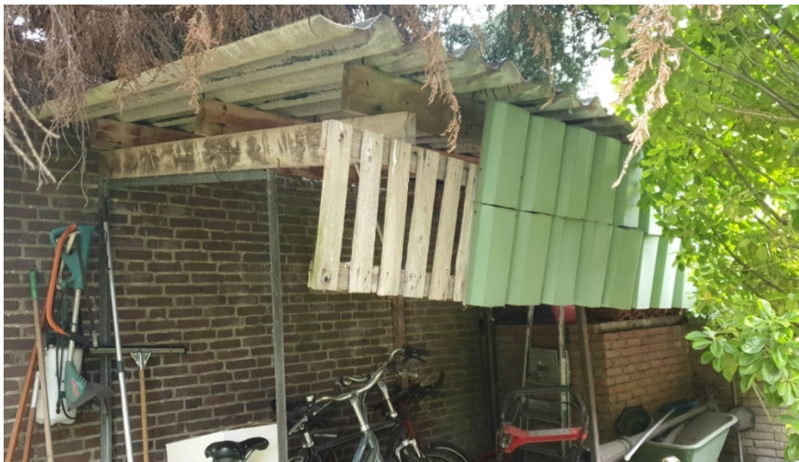
Foto 1: Asbestverdachte overkapping op Helmichstraat 34
