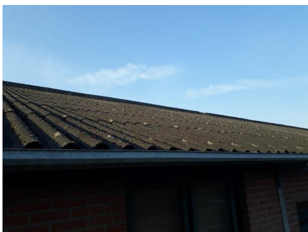
Asbest dak op de loods
