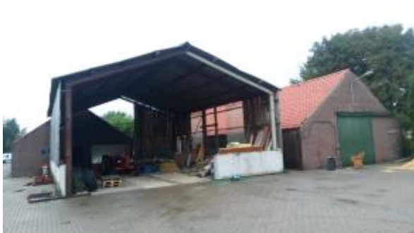
Foto 3: Schuur/overkapping op achterzijde erf met asbestverdachte dakplaten. Voor en naastgelegen de oude varkensstallen.
