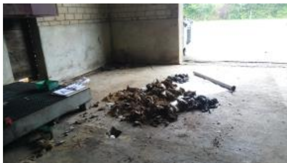
Foto 4: Lekbak is schuur boven betonvloer. Peilbuis 03P is nabij de lekbak geplaatst.
