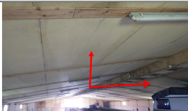
Foto nr. 7 plafond beplating loods 2, asbest M 1
