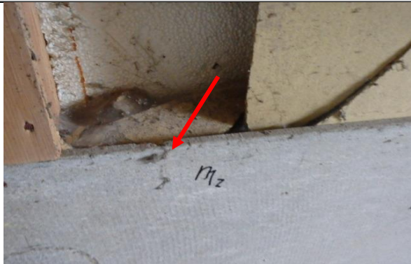
Foto nr. 4, lambrisering beplating in pandig loods 2, asbest M 2
