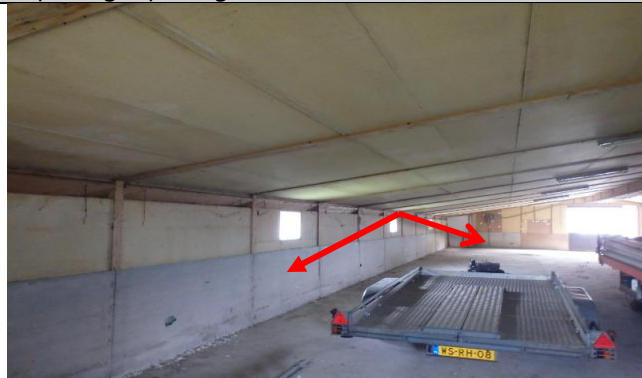
Foto nr. 5, lambrisering beplating in pandig loods 2, asbest M 2
