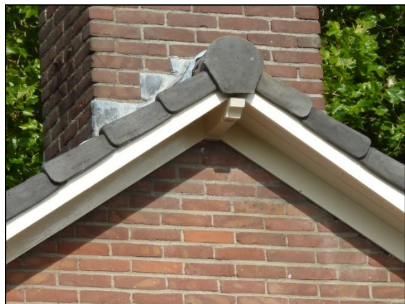
Figuur 15. Overhangende nokpannen worden vaak door vleermuizen gebruikt als verblijfplaats (vooral indien dit vlak bij een schoorsteen is).
