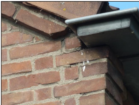
Figuur 10. Sporen van gebruik van de ruimte achter de dakgoot door broedvogels (mogelijk gierzwaluw).
