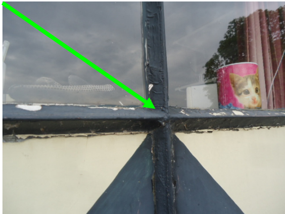
Afbeelding 7: Buitenzijde manege/Stopverf en beglazingskit
