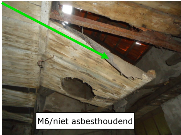
Afbeelding 15: Binnenzijde loods B/Bitumen op zolder
