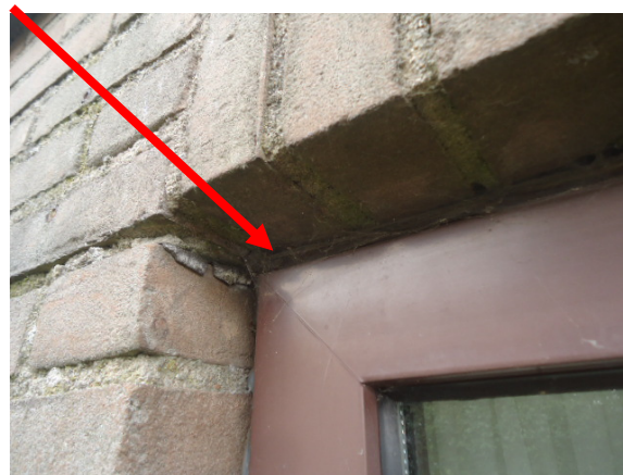
Afbeelding 4: Buitenzijde woonhuis/Bitumen boven kozijnen
