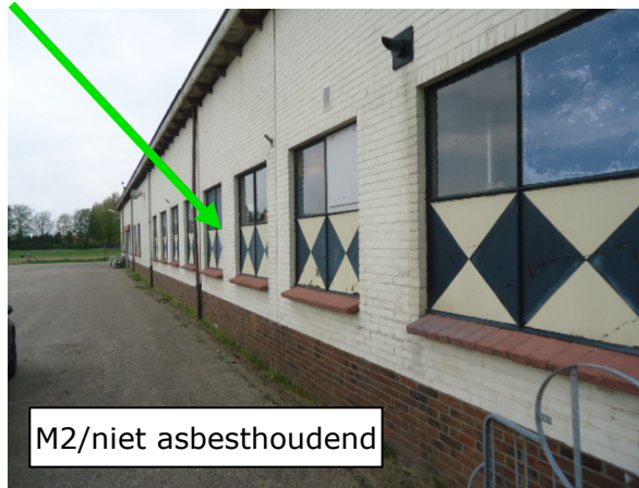
Afbeelding 6: Buitenzijde manege/Stopverf en beglazingskit
