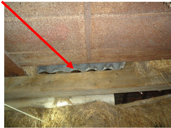
Afbeelding 19: Binnenzijde schuur C/Losse golfplaten/nokstukken
