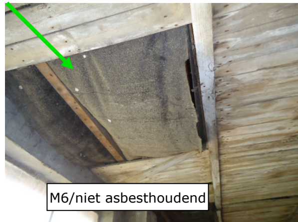
Afbeelding 14: Binnenzijde loods B/Bitumen op zolder
