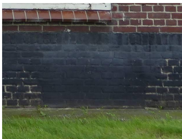
Figuur 31 – De locatie van het voormalige kelderraam.
