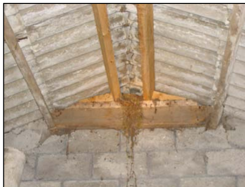
Foto 6: oud vogelnest in de nok van de schuur.
