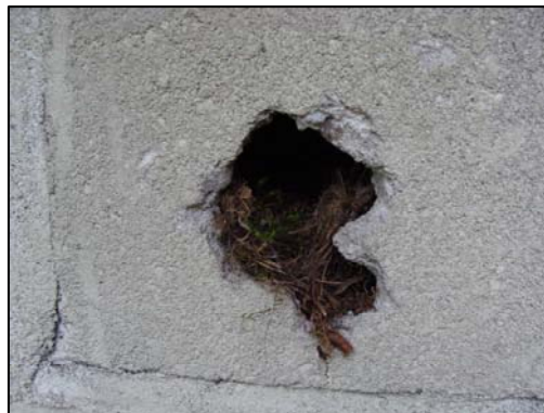
Foto 5: oud vogelnest in gat betonblok vermoedelijk winterkoning
