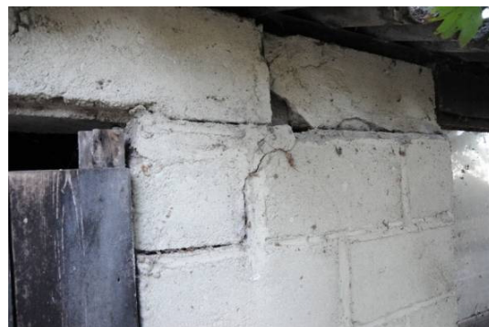
betonblokken en asbestverdachte golfplaten
