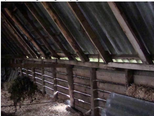
Ondersporen rusten op houten buitenwanden
