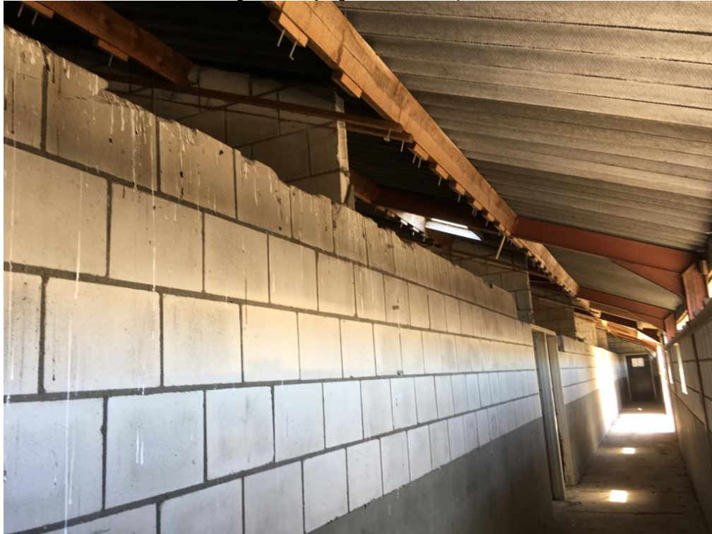
• Afbeelding 7: binnenzijde gebouw met uitwerpselen van kauwen
