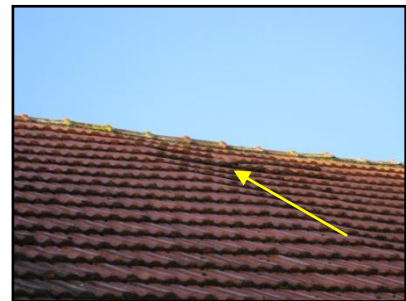
Figuur 17. Ruimtes tussen dakpannen.
