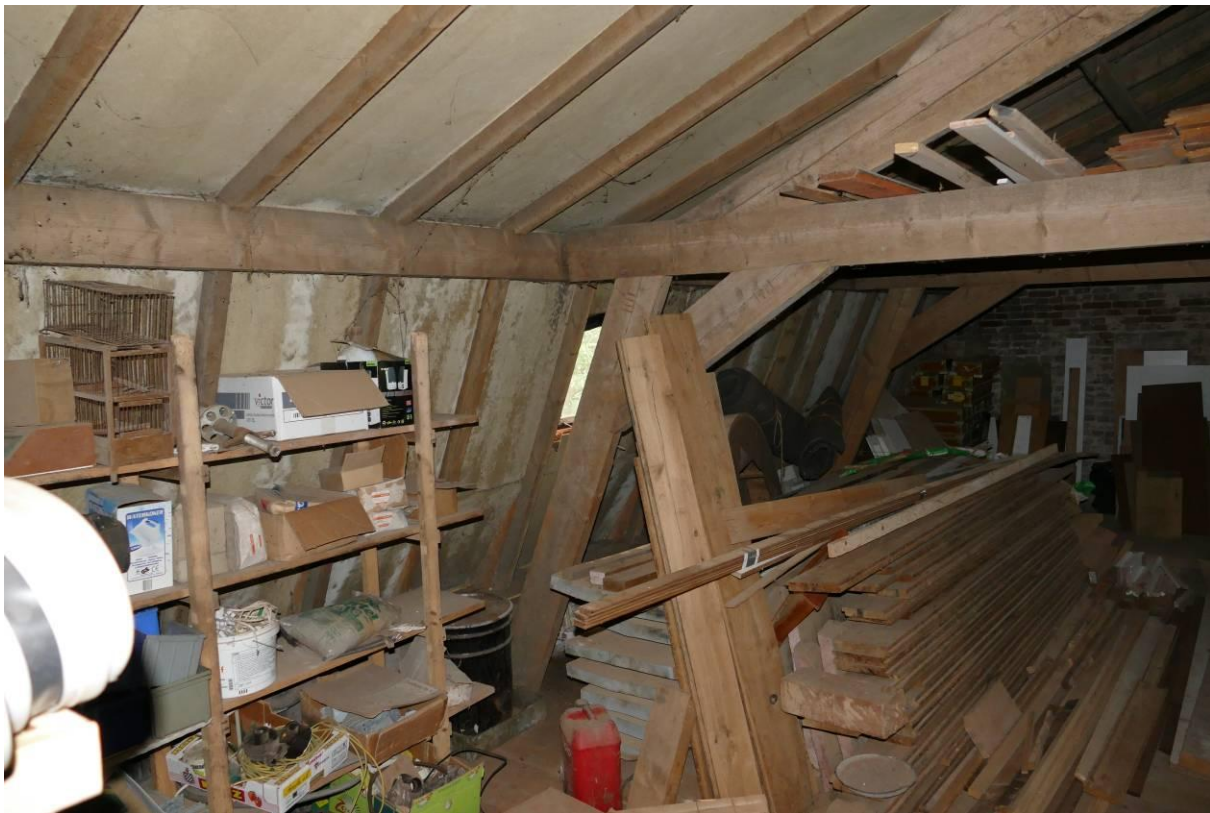
Figuur 52 – Twee jukken in het bedrijfsgedeelte.
