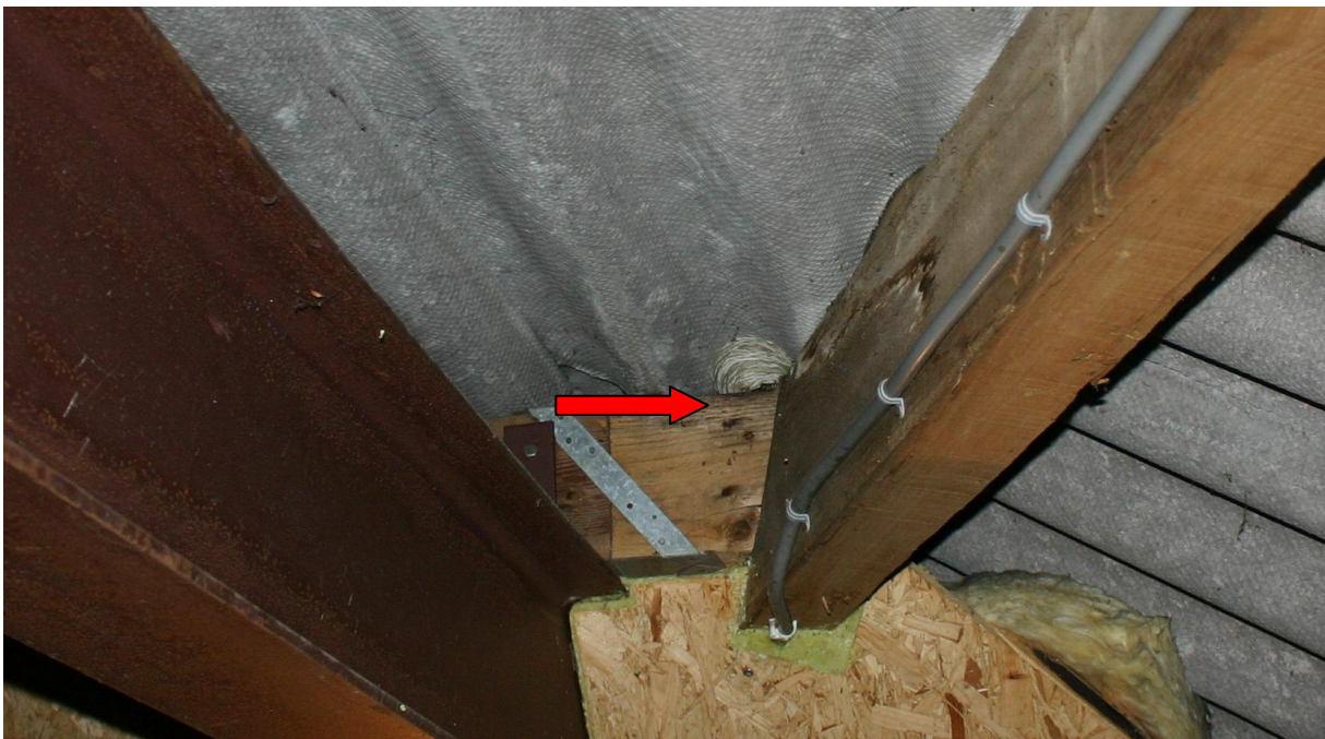
Figuur 10. Bewoond wespennest tussen het dak en een steunbalk op de zolder van de bedrijfswoning.
