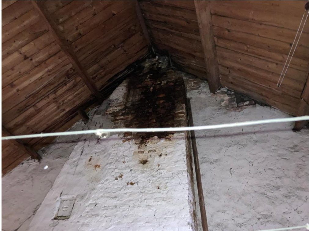
• Afbeelding 14: zolder woonhuis brandmuur met lekkage
