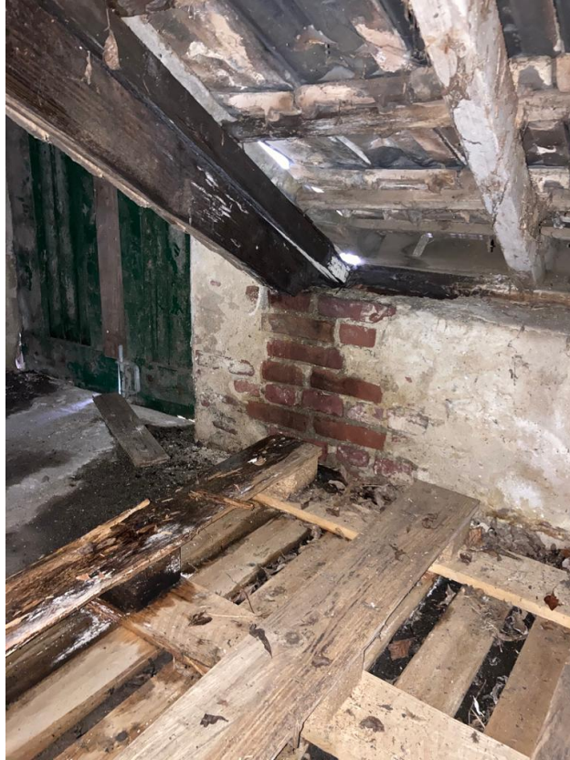
• Afbeelding 26: lekkage in schuurgedeelte woonhuis
