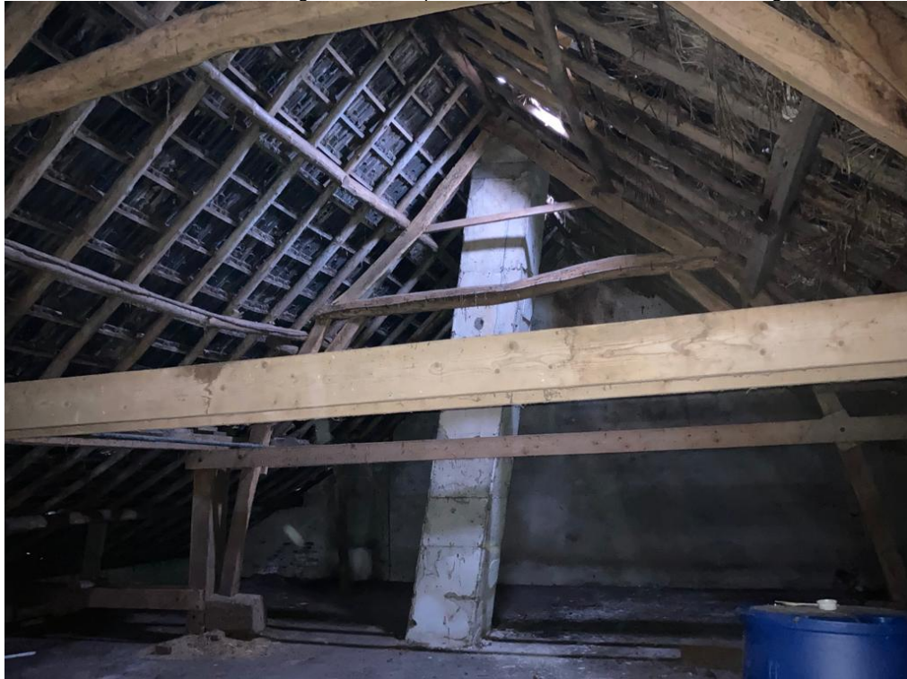
• Afbeelding 24: enkele kapconstructie zolder woonhuis met kieren en gaten
