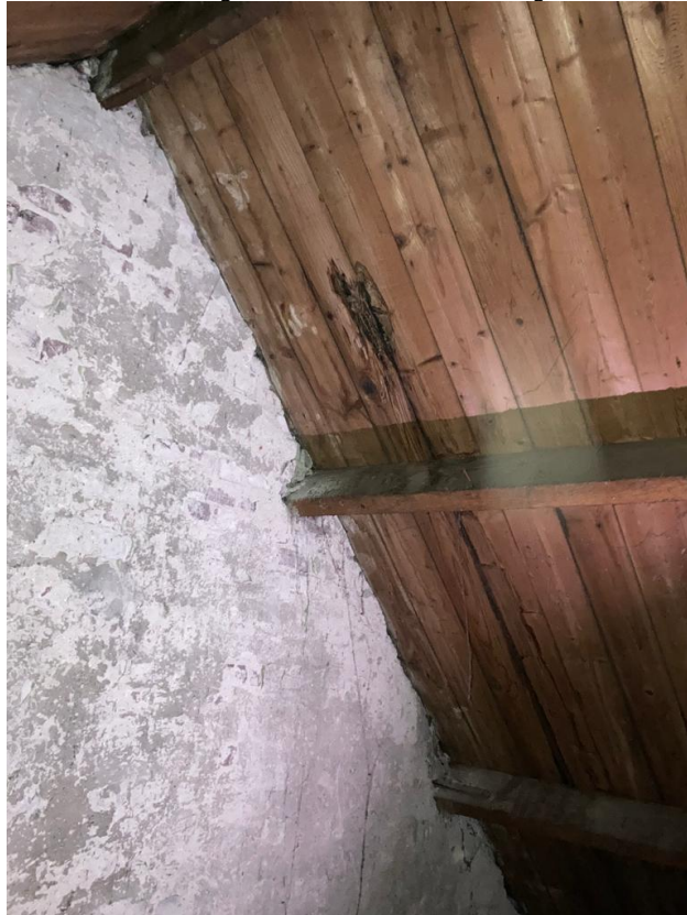
• Afbeelding 16: zolder woonhuis met lekkage
