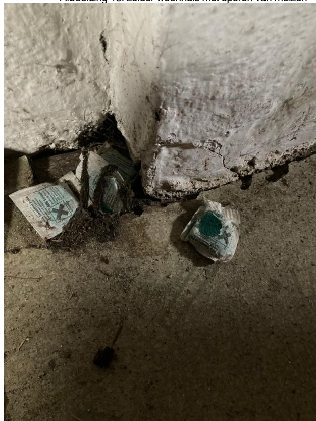
• Afbeelding 15: zolder woonhuis met sporen van muizen
